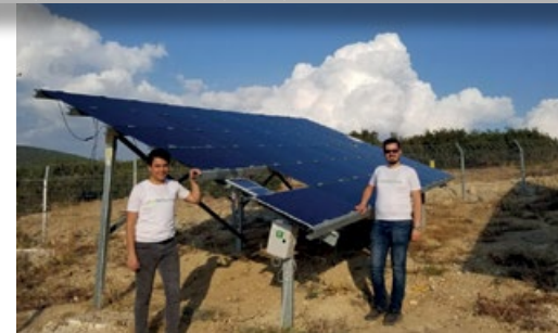
Demircioğlu Pilot Uygulaması Isparta Gönen Güneş Enerji Santrali
